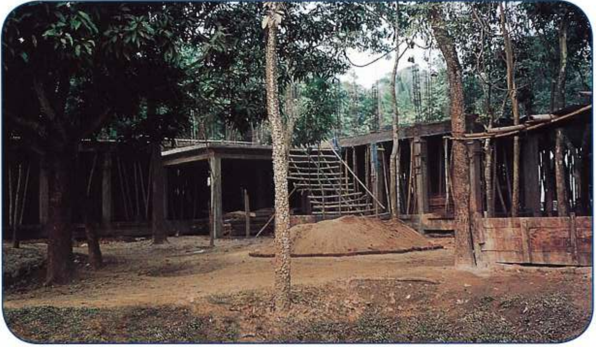
مشروع بناء مدرسة متوسطة في قرية فيريور بمدينة نرسندي في دولة بنغلاديش وقد تم صب سقف الدور الأول في ٢٠٠٧/١/١٧
