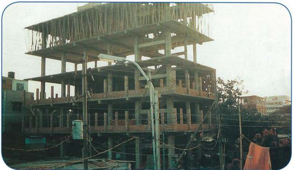
مشروع بناء مسجد بيت الحق ومدرسة في ميربور - دكا في دولة بنغلادش، وقد تم صب سقف الدور الرابع في ٢٧/٣/٢٠٠٧م
