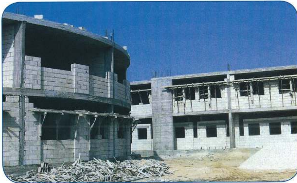
مشروع بناء مدرسة جديدة في وادي خالد عكار في لبنان، وقد اكتملت مراحل بناء الهيكل الأساسي (الأسود) في ٢٠٠٧/٣/٤
